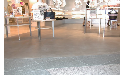
店舗床劣化防止
